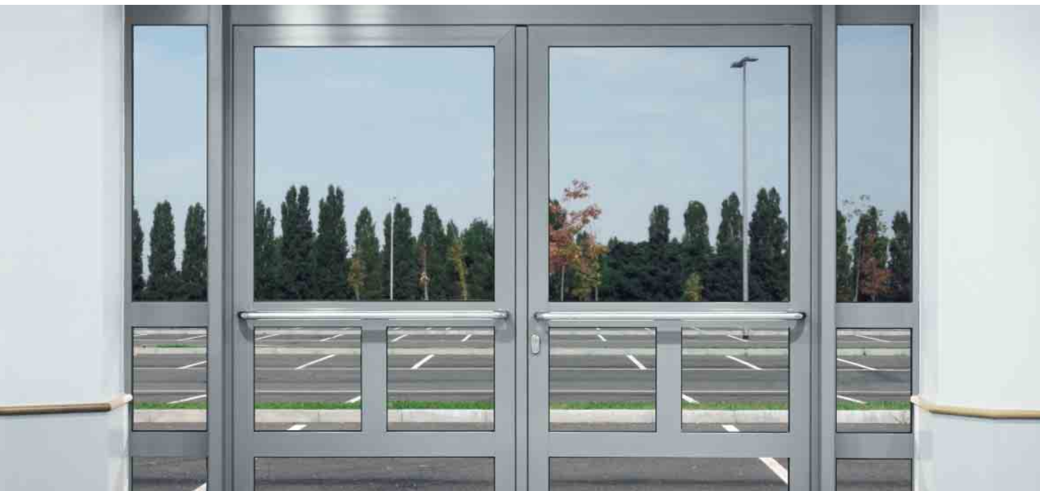
Sicherung von Türen Door security
